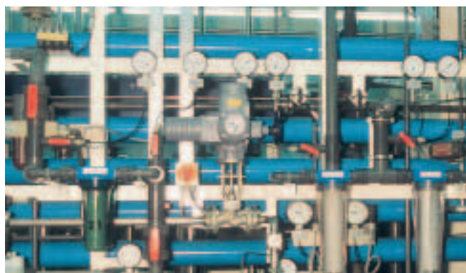
Привод AUMA, работающий в режиме регулирования. Смонтирован на регулирующую задвижку на опреснительном заводе.
