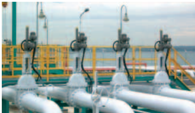
Приводы AUMA, установленные на клиновых задвижках. Топливная база в аэропорту Чубу, Япония
